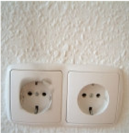
Abb. 1 Rußfahne an einer benutzten Steckdose 6
